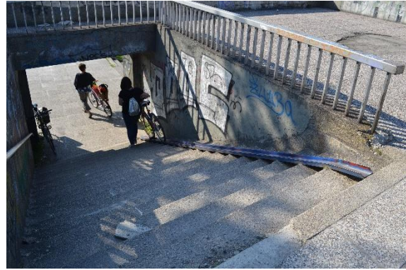
Slika 38. Kanalice na stepenicama na Mostu mladosti
