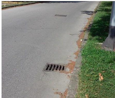
Slika 13. Nepravilno usmjerene rešetke na odvodnom šahtu u Ulici Dane Dujića
