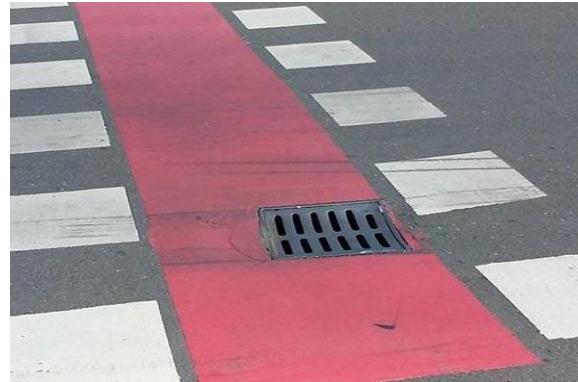
Slika 18. Nepropisno postavljene slivne rešetke na Aveniji Dubrovnik
