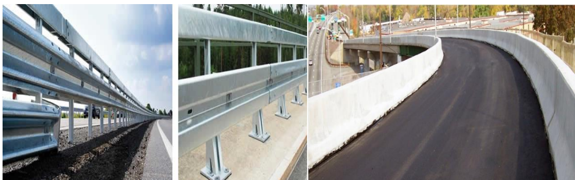
Slika 24. Zaštitne odbojne ograde [23]
