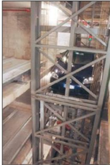
Slika 10.: Dizalo u kombinaciji sa horizontalnom platformom; [1] Brčić, Šoštarić
