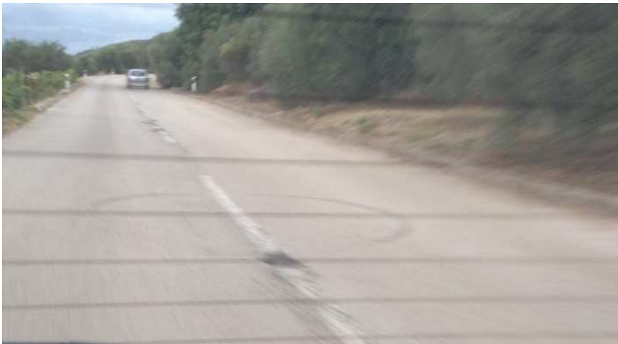
Slika 13. Istrošeni asfalt na dionici Čara-Smokvica
