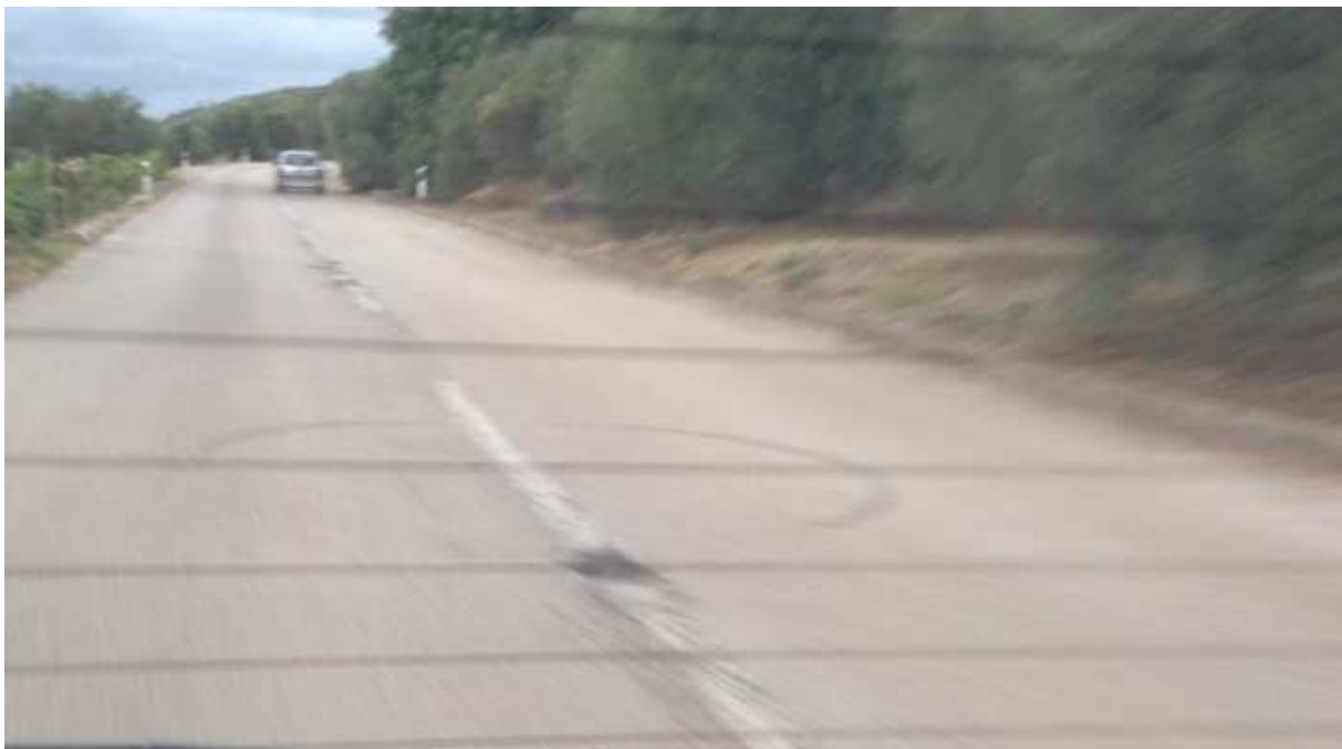
Slika 13. Istrošeni asfalt na dionici Čara-Smokvica
