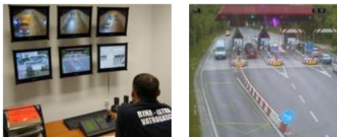
Slika 3: Sustav u tunelu Učka
