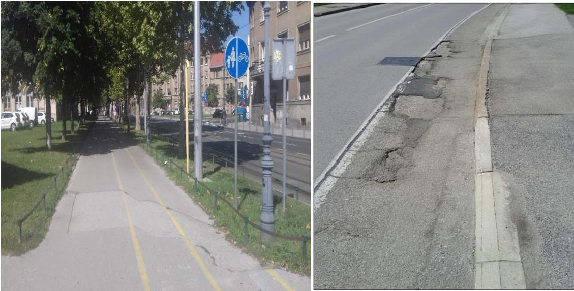
Slika 10. Nepravilna primjena prometnih elemenata i oštećenja [15]
