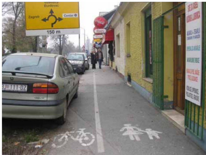
Slika 24. Loše izvedena biciklistička staza u Bjelovaru [19]
