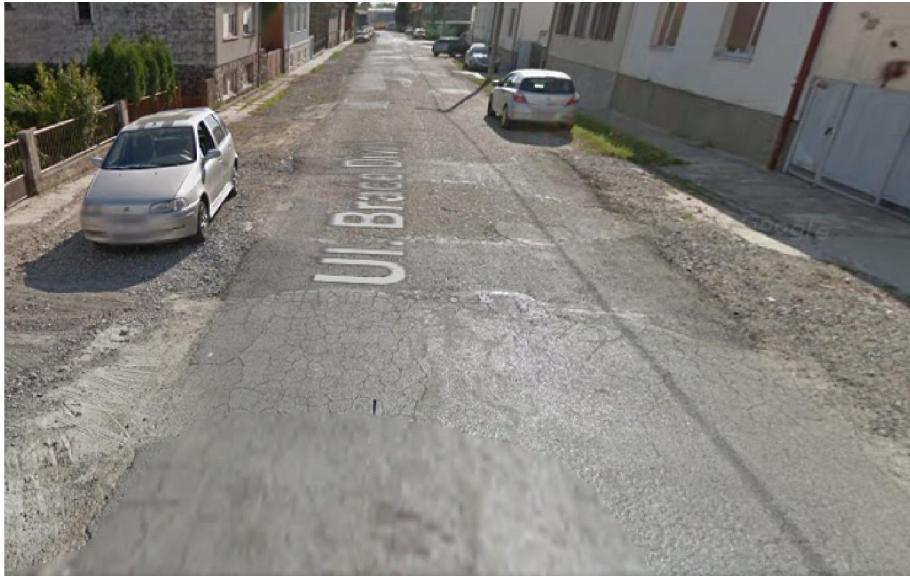
Slika 22. Oštećenje kolnika u Ulici Braće Radić u Bjelovaru [20]
