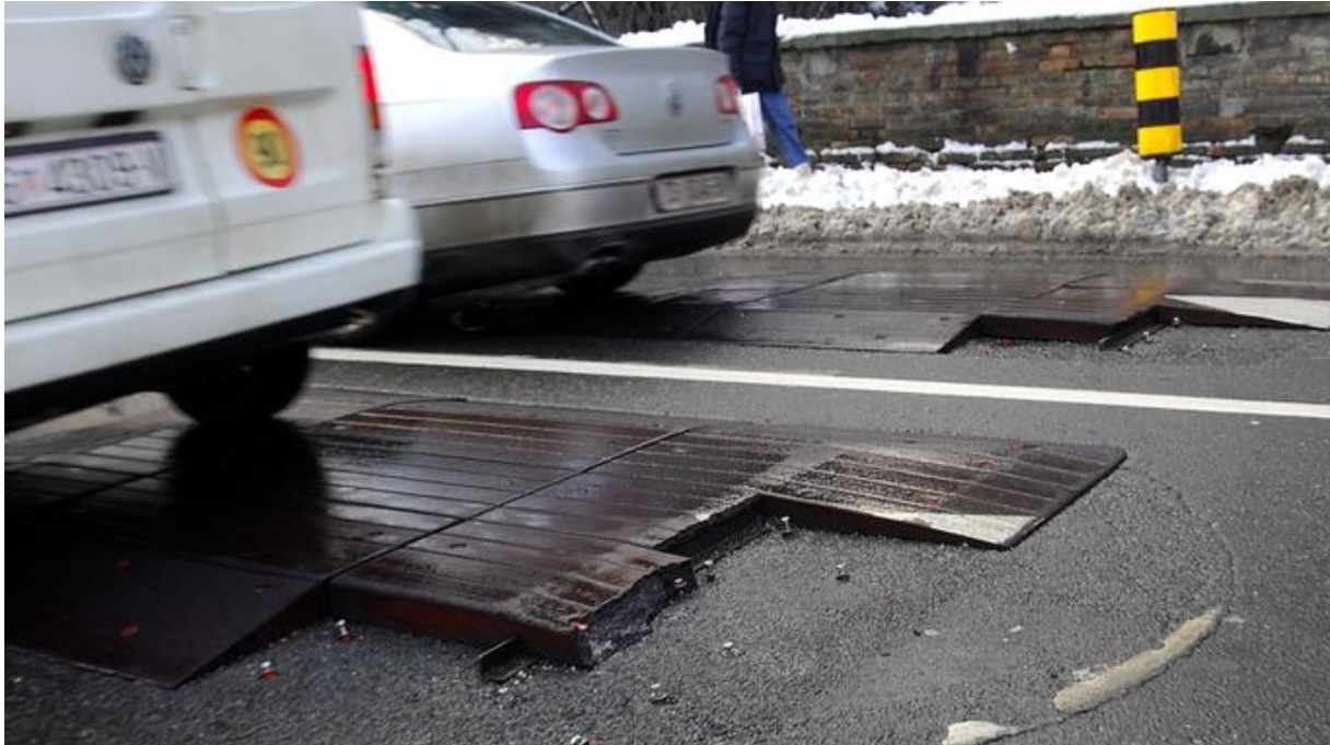
Slika 11. Primjer oštećenog uspornika
