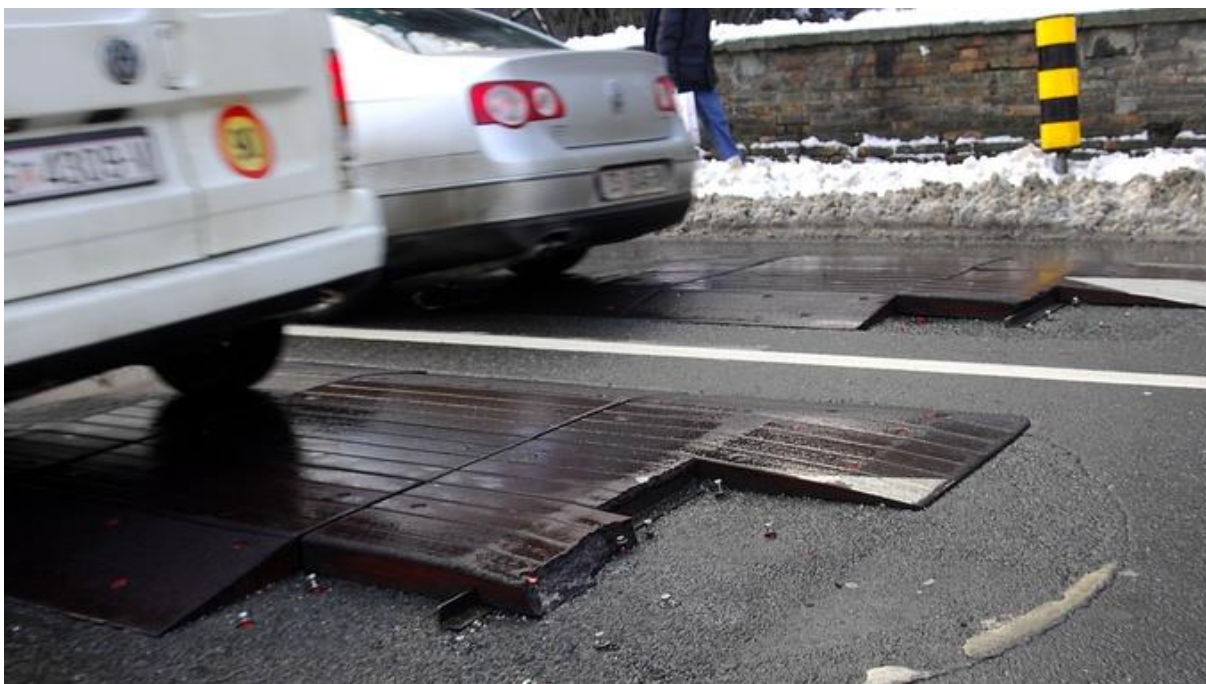
Slika 11. Primjer oštećenog uspornika
