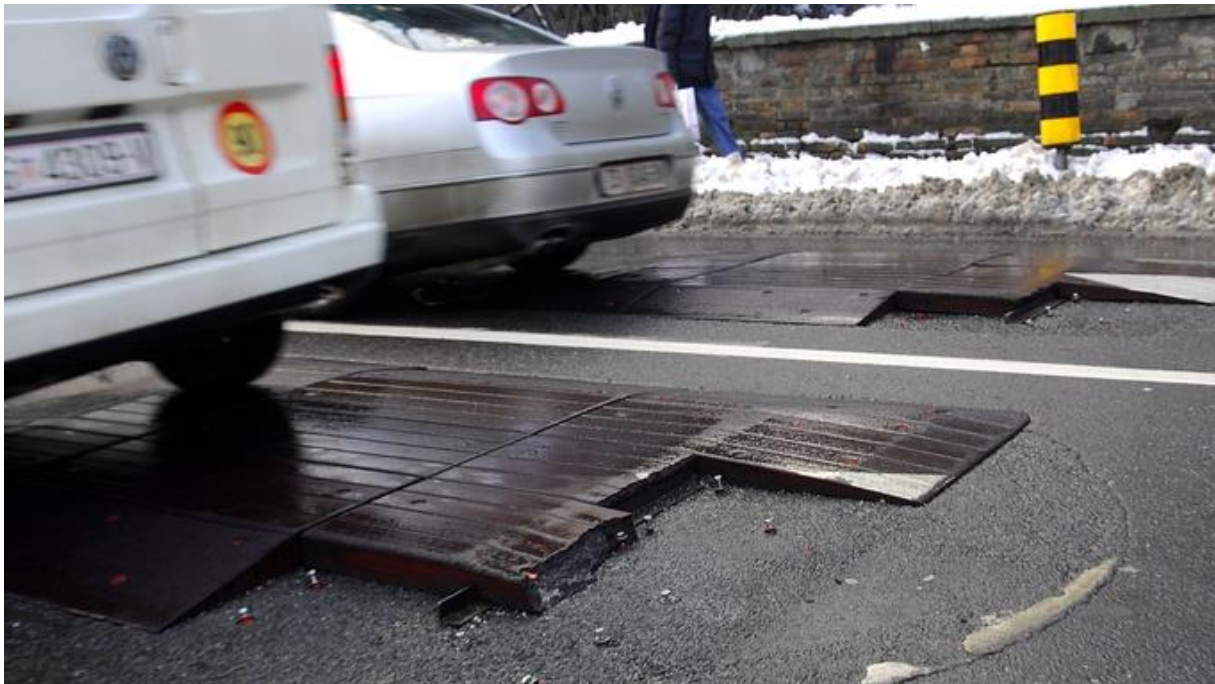
Slika 11. Primjer oštećenog uspornika
