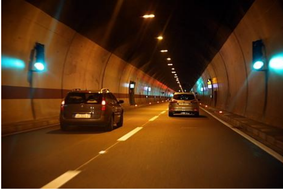
Slika 14. Centralni raspored rasvjete u tunelu
