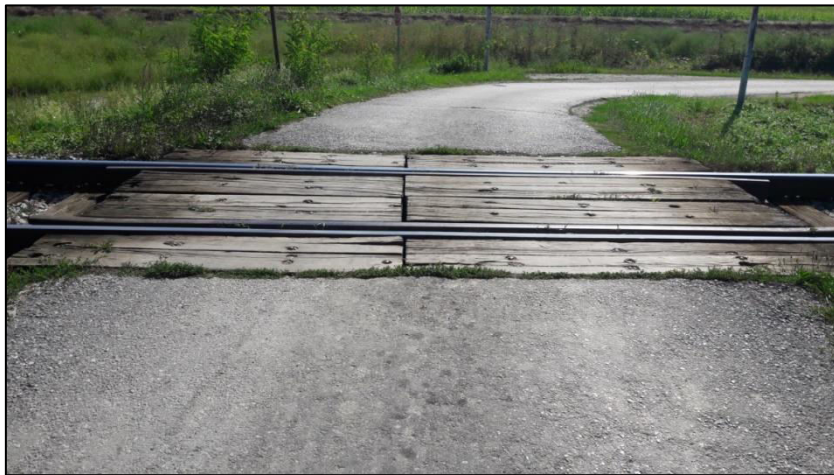
Slika 14. Prikaz stanja pragova na željezničko-cestovnom prijelazu „Caginec“
