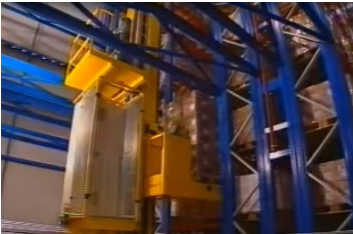
Slika 26.: Visokoregalna automatizirana S/R dizalica unutar skladišta Izvor: [12]
