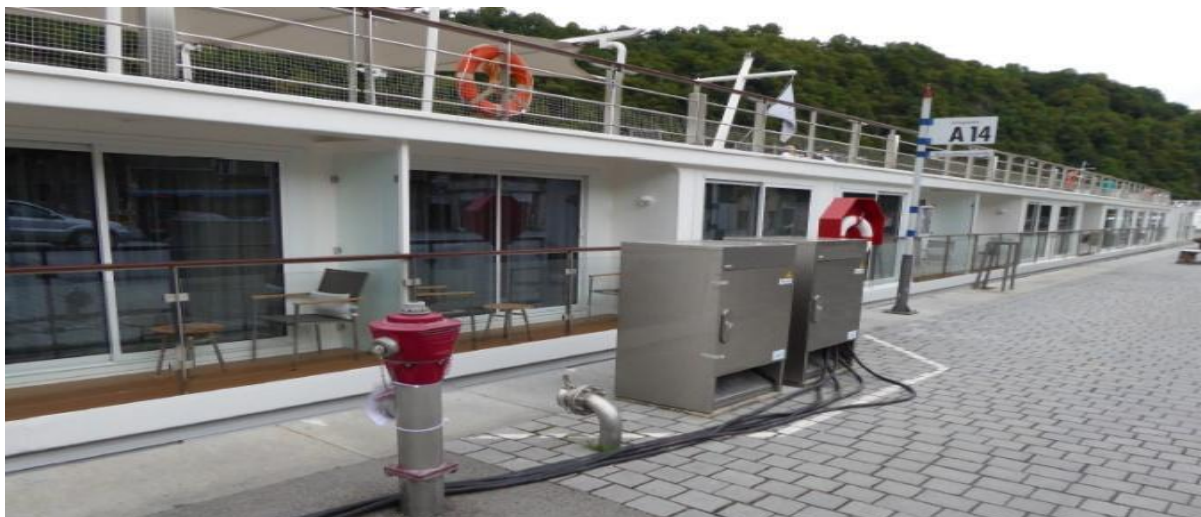
Slika 20. Prikaz pristana u luci Passau te priključaka za električnu energiju, vodu i odvod Izvor: https://www.stadtwerke-passau.de/hafen/schiffahrt/anlegestellen.html (30.07.2016.)
