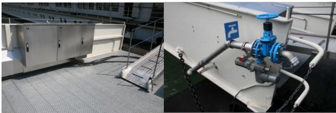
Slika 23. Prikaz opskrbe plovila vodom i električnom energijom na pristanu St. Johannspark Izvor: http://www.port-of-switzerland.ch/ (30.07.2016.)
