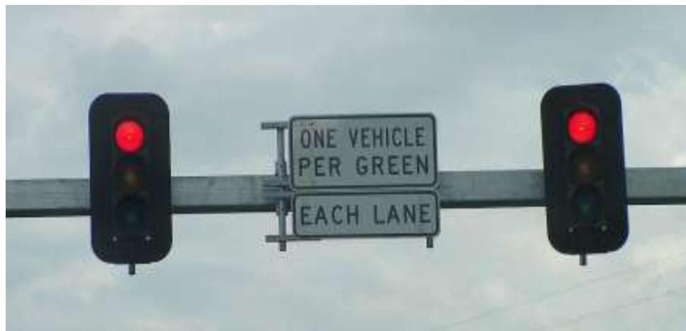
Slika 13 - Semafori uređaji za sustav upravljanja priljevnim tokovima prometa, Izvor [14]
