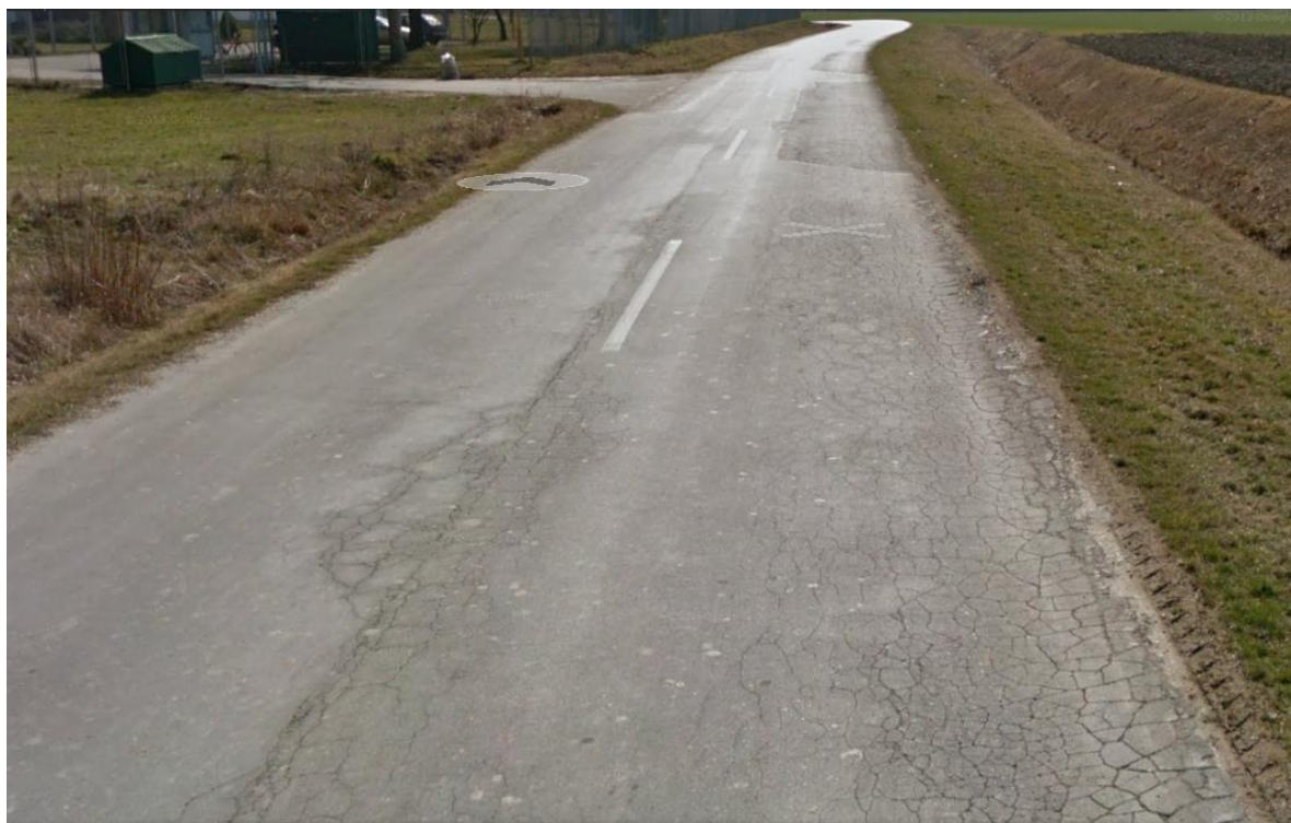
Slika 11. Dio kolnika na županijskoj cesti ŽC 2150
