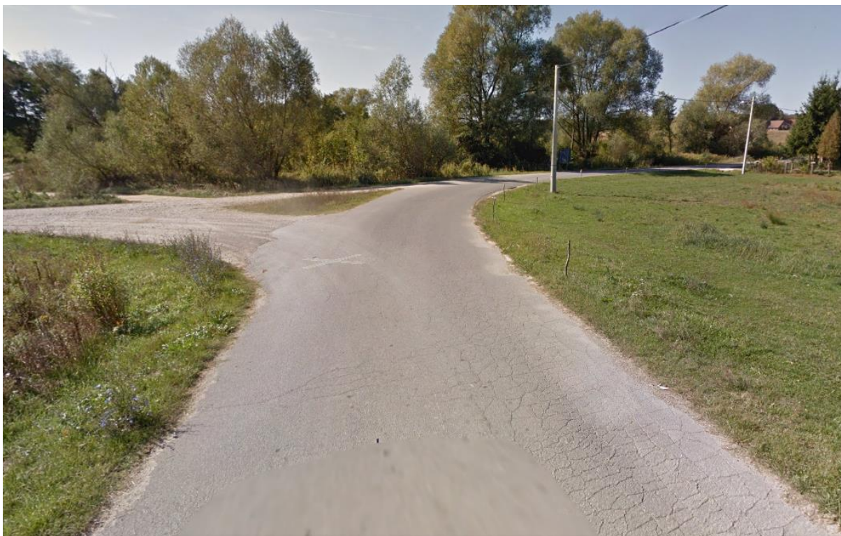
Slika 21. Nedostatak prometne signalizacije i nedostatna širina kolnika na lokalnoj cesti LC 26082 u naselju Mala Mučna
