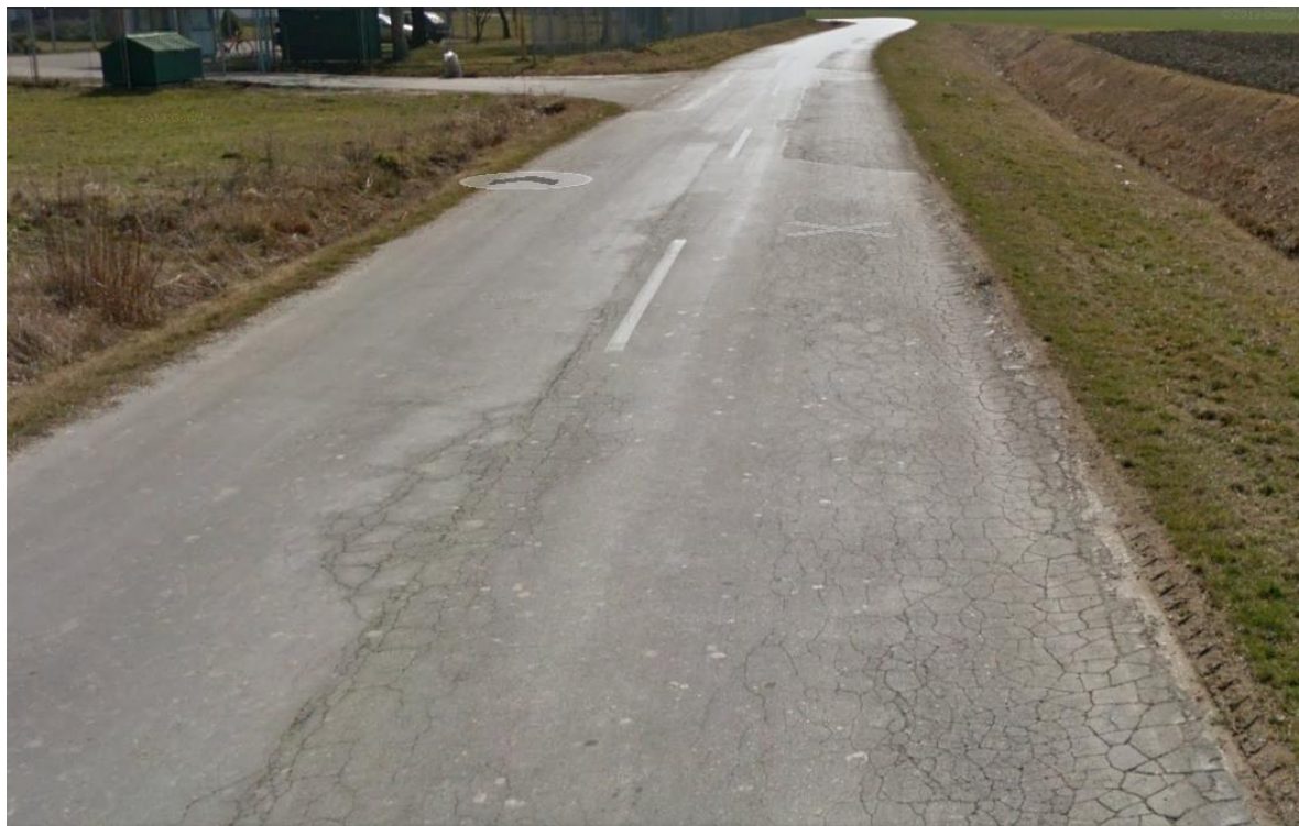
Slika 11. Dio kolnika na županijskoj cesti ŽC 2150
