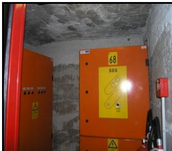
Slika 28. SOS telefon u tunelu, izvor [28]
