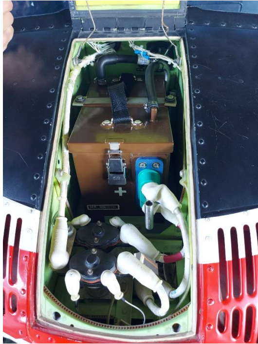
Slika 5. Priključeni akumulator na helikopter Bell 206
