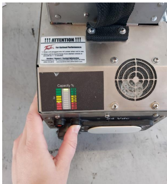
Slika 23. Prikaz napunjenosti akumulatora (100 %)
