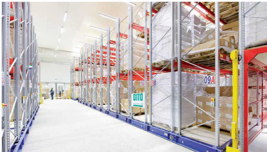
Slika 11. Pokretni regalni sustav za skladištenje robe u hladnjači
