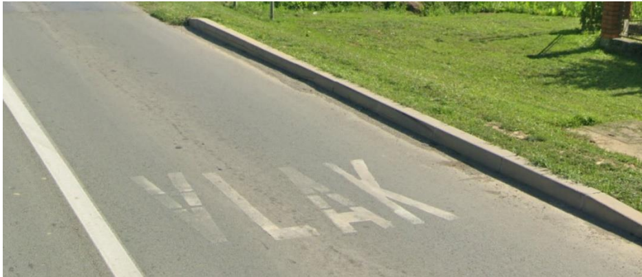
Slika 36. Izbledila oznaka na kolniku
