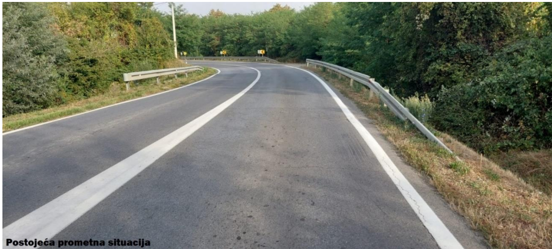
Slika 37. Postojeće stanje bez zaštitne ograde
