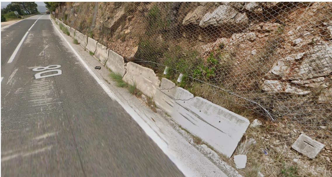
Slika 22. Neadekvatna izvedba betonske zaštitne ograde Izvor:[23]
