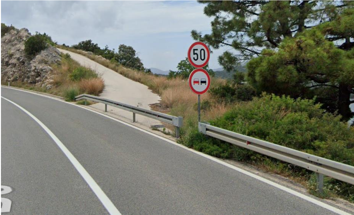
Slika 18. Neispravno izveden završetak/početak čelične zaštitne ograde – Primjer 2 Izvor:[23]
