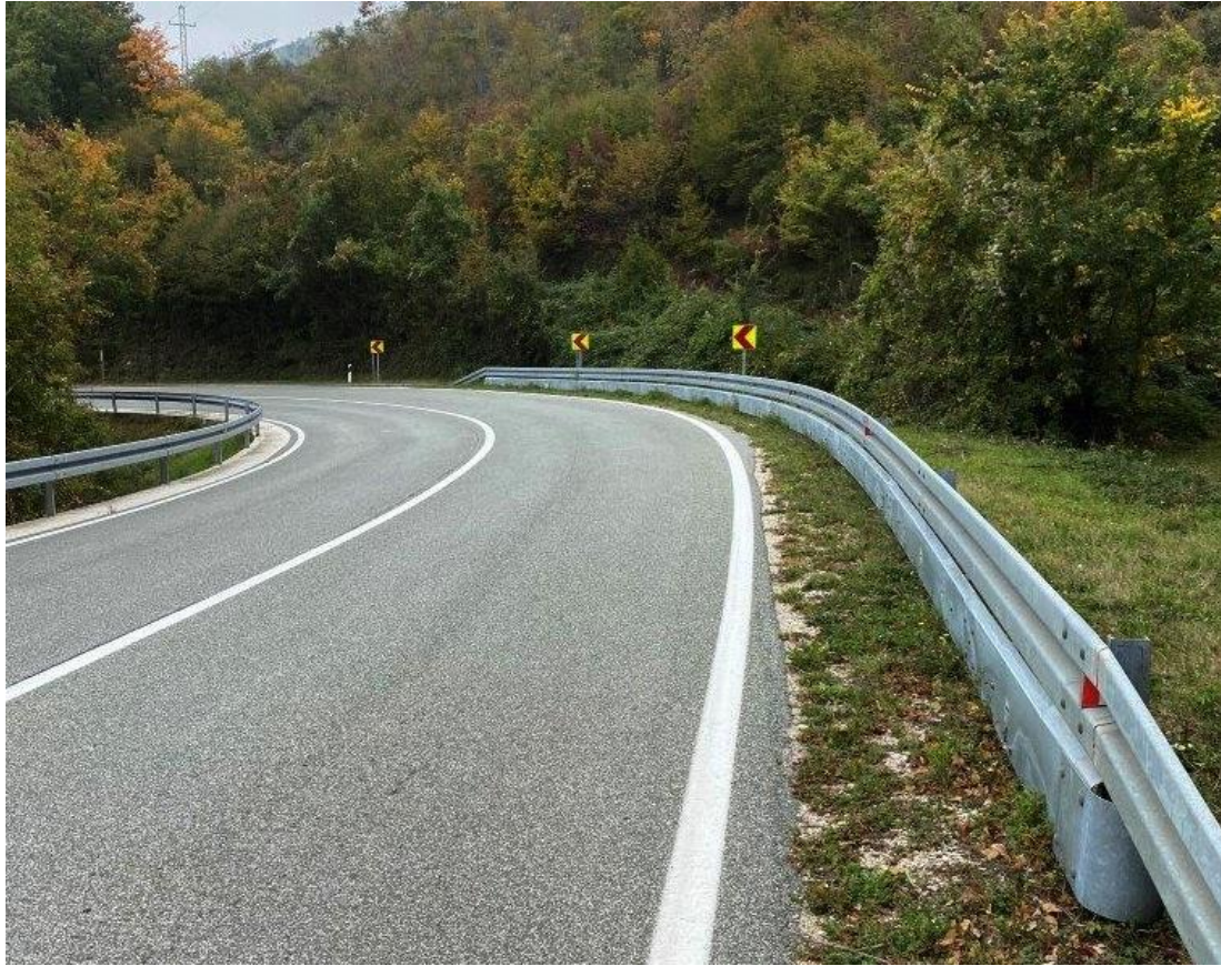
Slika 32 Primjer dodatne zaštitne ograde za motocikliste izvedene na čeličnu zaštitnu ogradu Izvor:[25]
