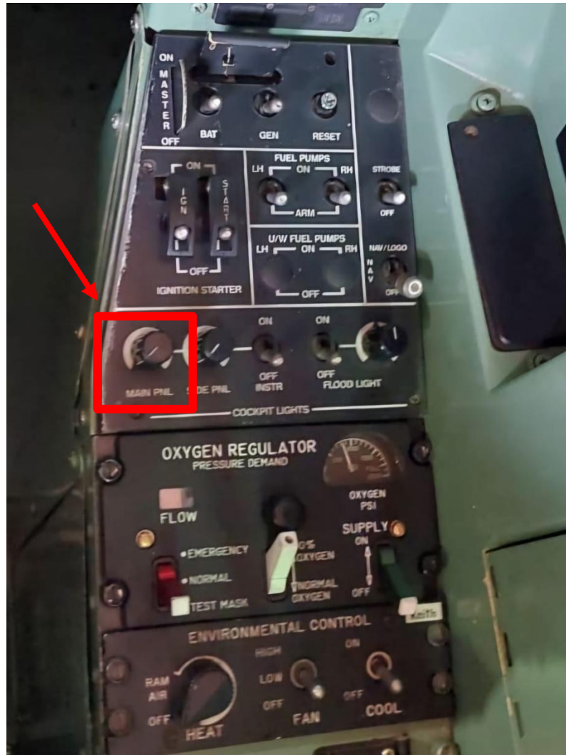
Slika 6. Sklopka MAIN PNL
