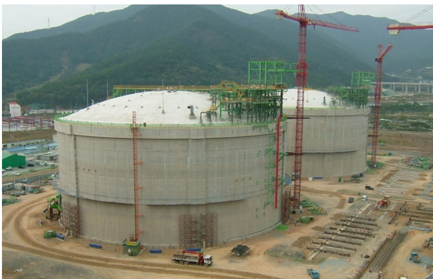
Slika 6. Nadzemni LNG spremnik [34]
