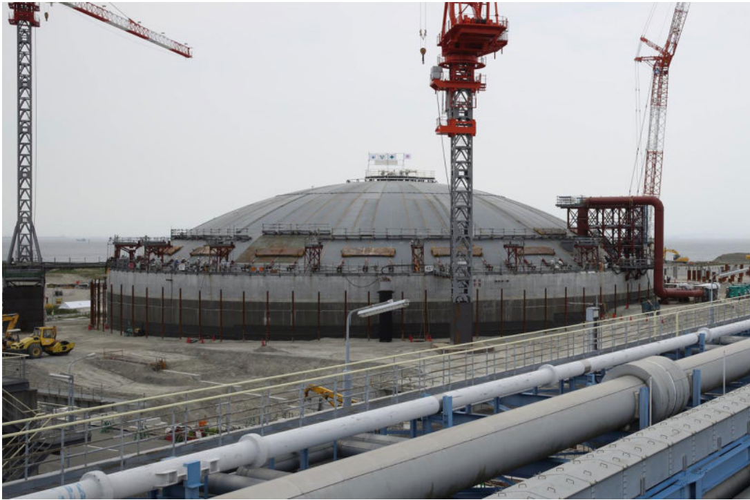
Slika 7. Podzemni LNG spremnik [ 35]
