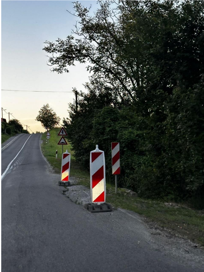
Slika 4: Oštećenje rubnog dijela prometnog traka na županijskoj cesti ŽC2195 (Jezero Klanječko)
