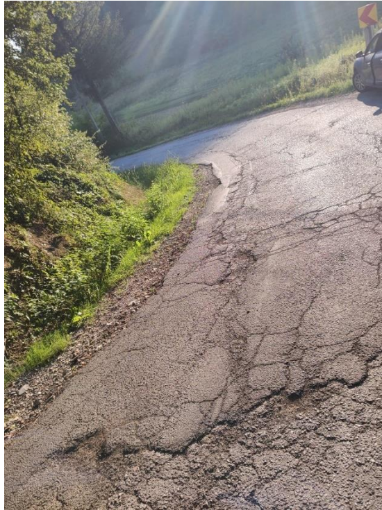
Slika 9: Stanje zastora u oštrm zavoju na nizbrdici na županijskoj cesti ŽC2118 (Gorjakovo)
