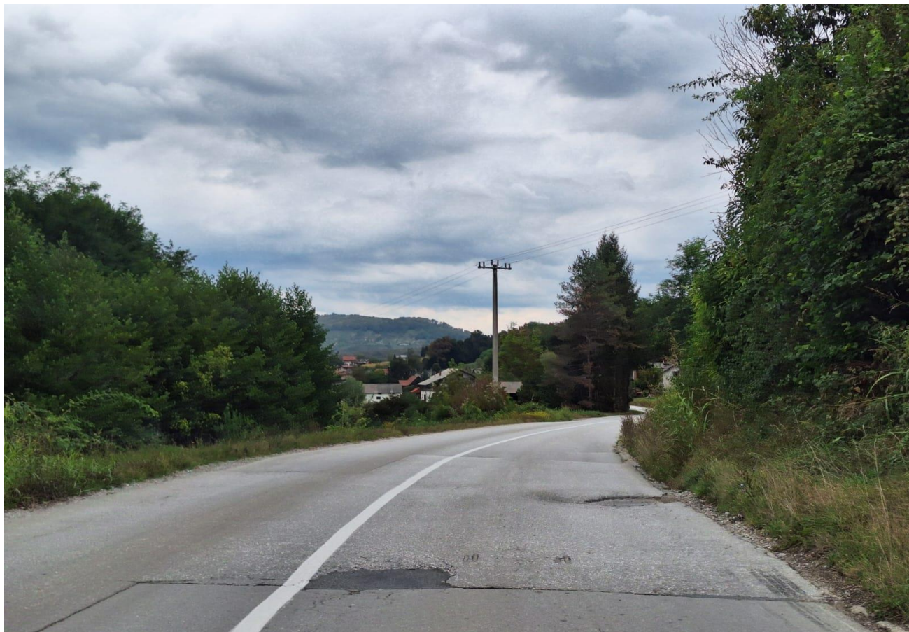
Slika 16 Oštećenje kolničkog zastora na ŽC3185
