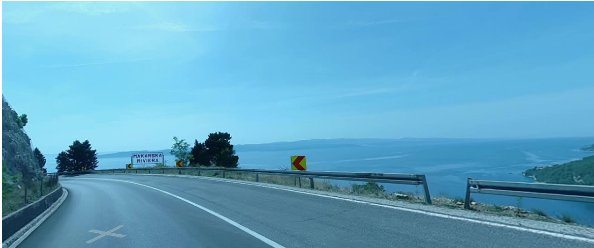
Slika 36. Zavoje DC8 kod naselja Brela gdje je vidljiv nedostatak na zaštitnoj ogradi
