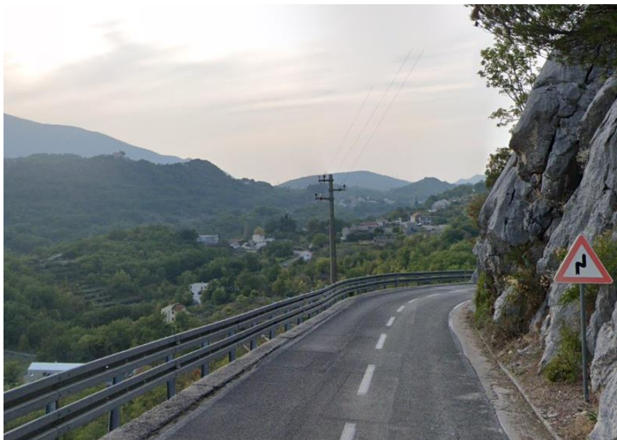
Slika 21. Širina prometne trake na državnim cestama manja od 2,75 m (visoki stupanj)
