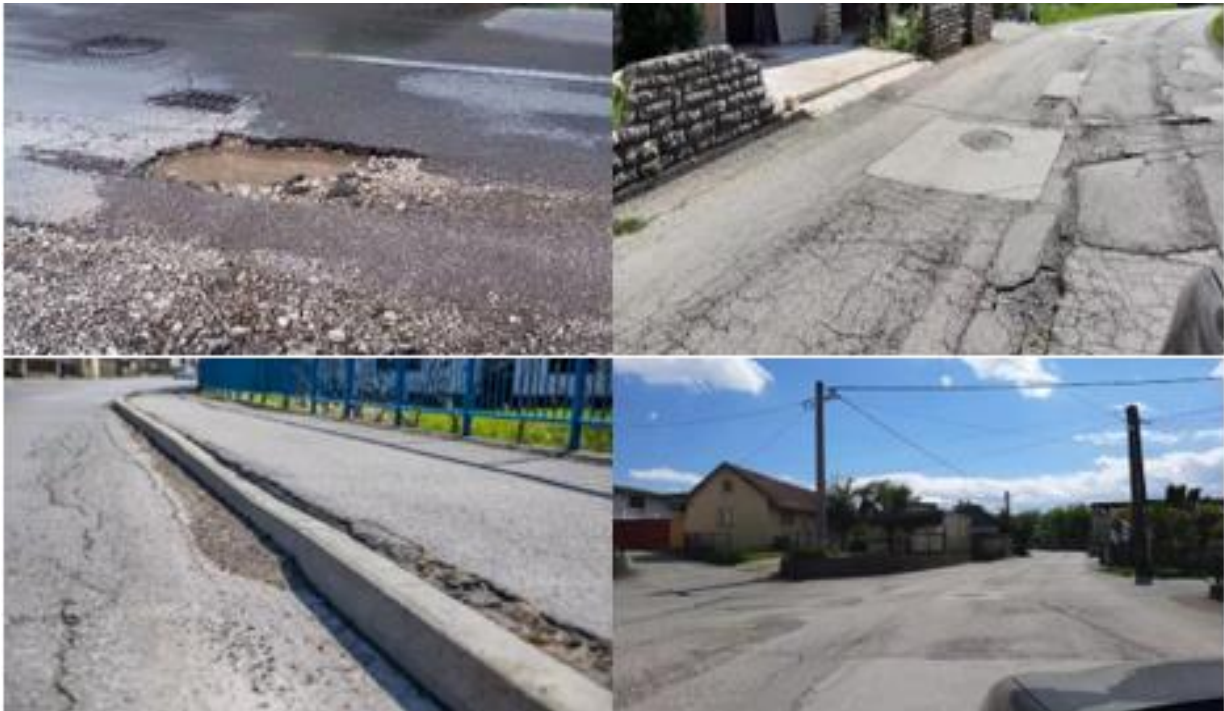
Slika 4. Oštećeni kolnici na području Karlovačke županije
