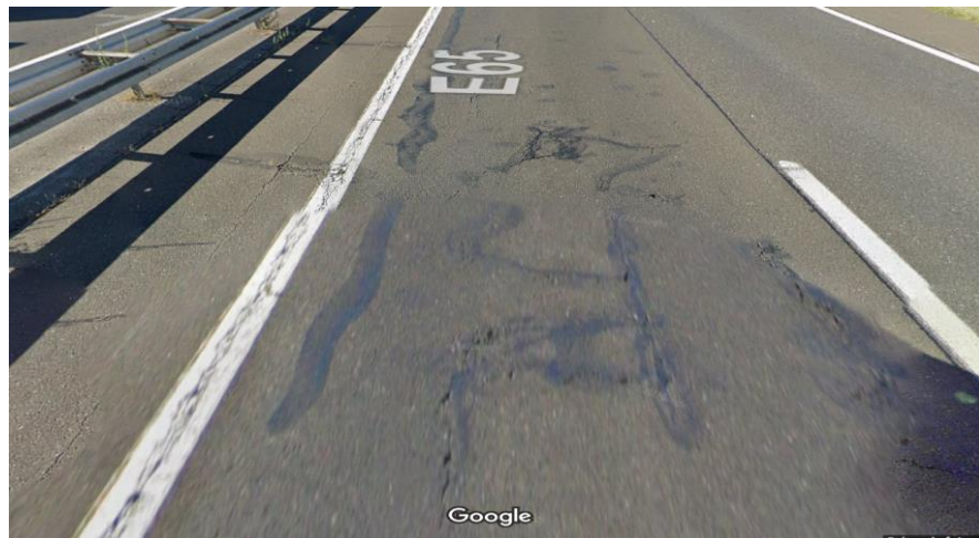
Slika 16. Izgled kolnika promatrane dionice
