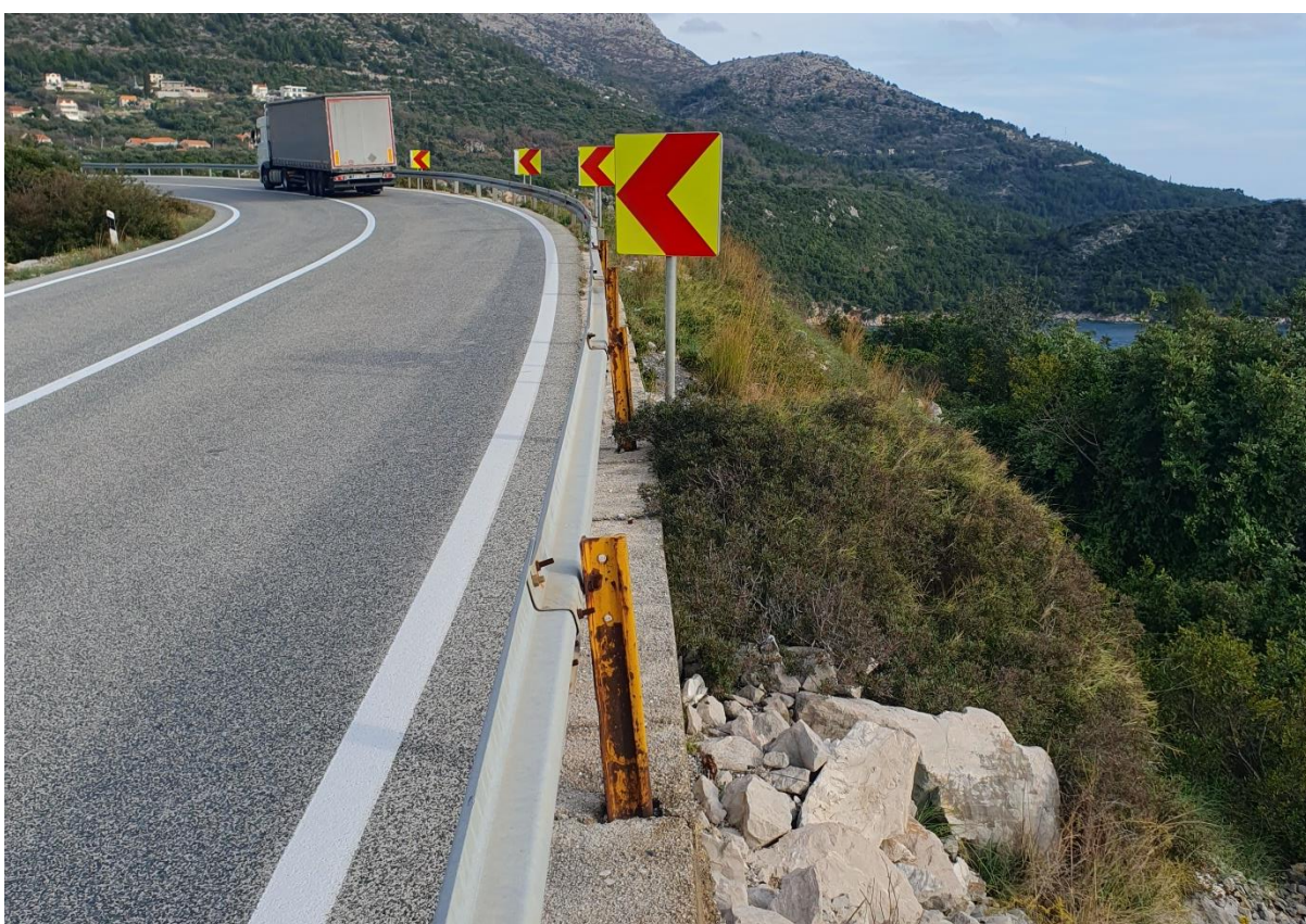
Slika 14. Stari stupovi zaštitne ograde
