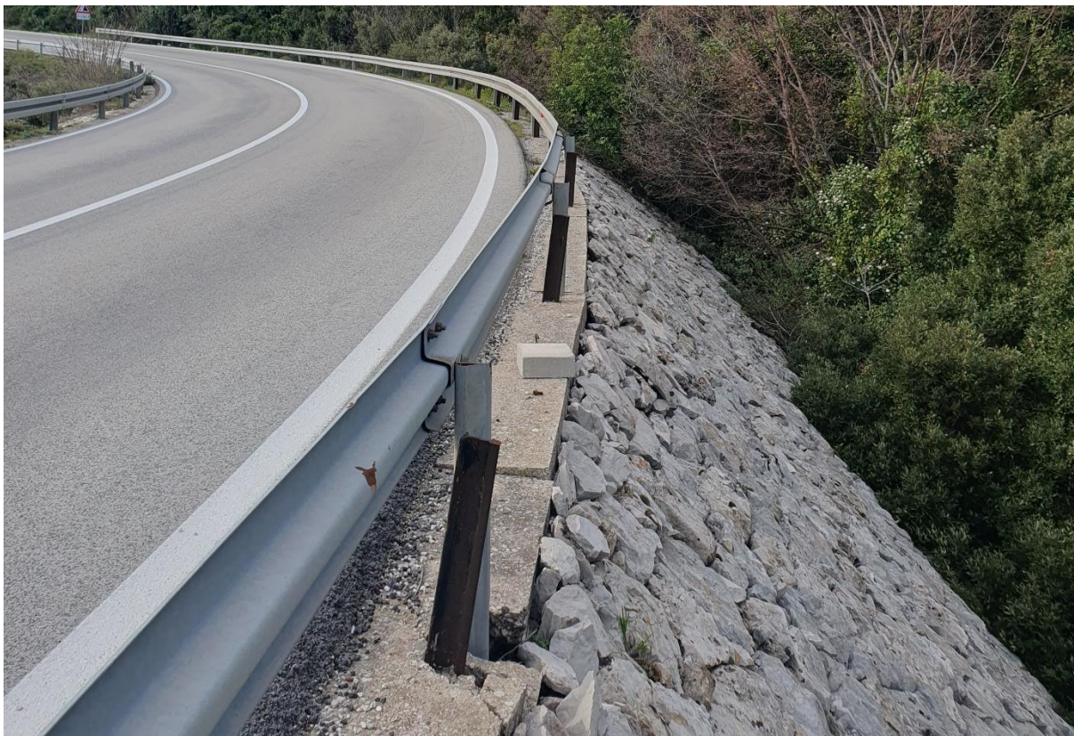
Slika 18. Neuklonjeni nezaštićeni stari stupovi zaštitne ograde
