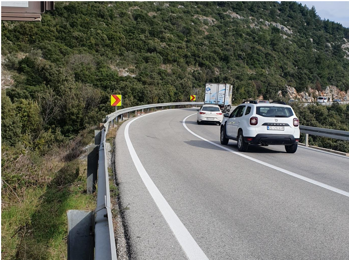
Slika 17. Oštećen plašt čelične zaštitne ograde
