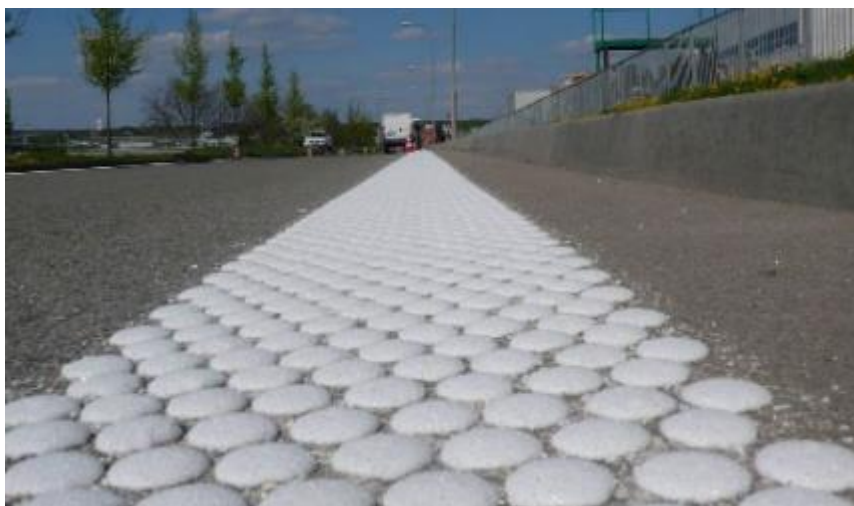
Slika 6. Strukturirana oznaka na kolniku [2]
