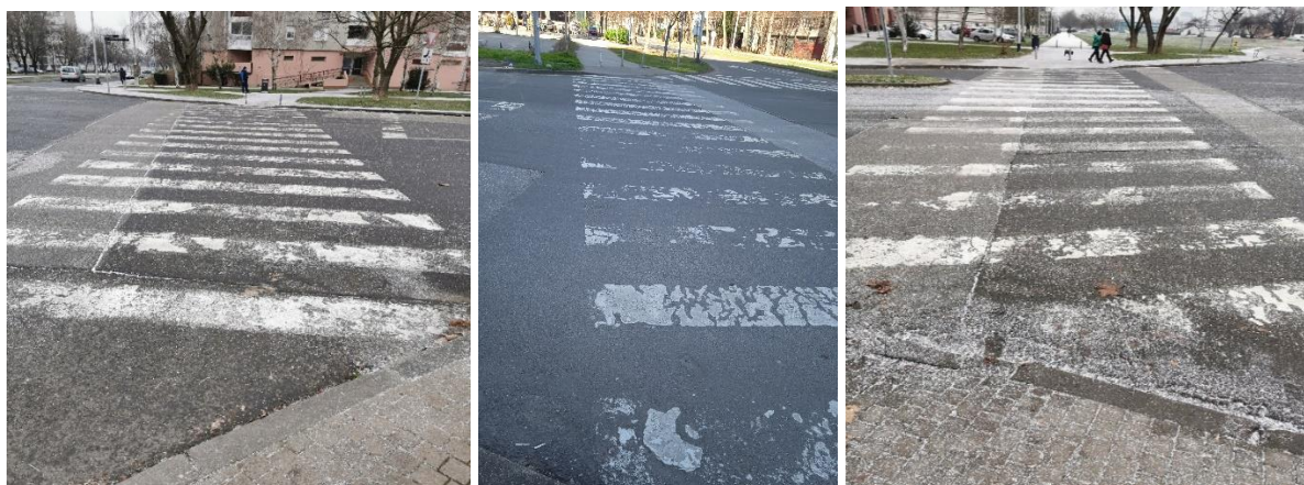
Slika 12. Dotrajalo stanje pješačkog prijelaza na privozima 3 i 4
