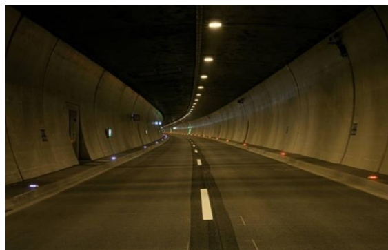
Slika 28: Smjerokazne oznake u tunelu
