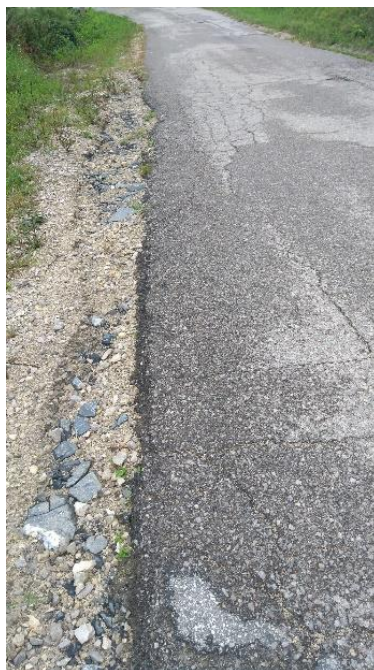
Slika 8. Prikaz oštećene bankine u mjestu Veliki Lipovec
