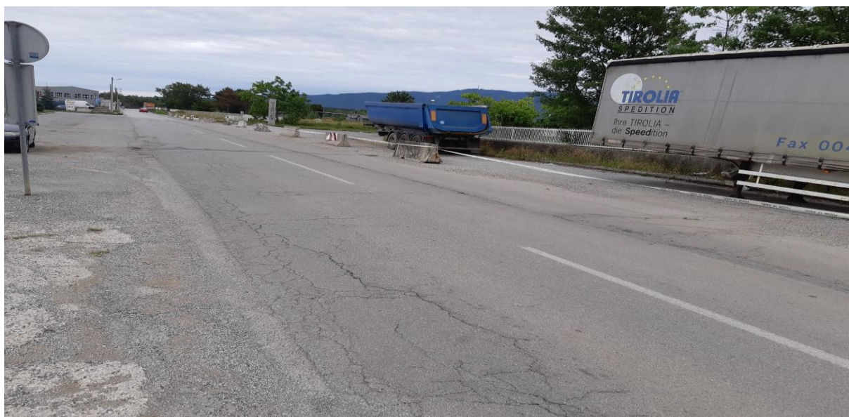
Slika 9. Oštećen kolnik na ŽC3036 (Pojatno (Ž2195) – D. Bistra (Ž3007))
