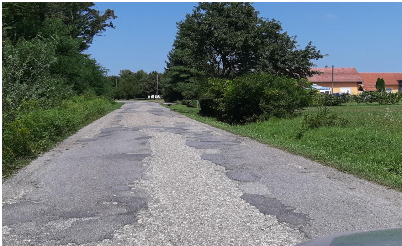
Slika 19. Dio kolnika na županijskoj cesti u mjestu Brežane Lekeničke
