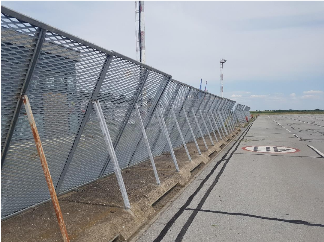
Slika 25. Prikaz jet blast deflektora koji su pogrešno postavljeni
