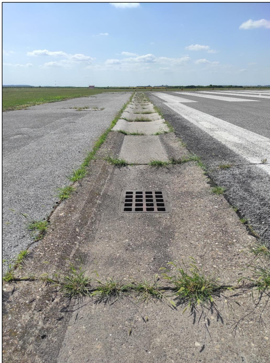
Slika 12. Rešetke za odvodnju
