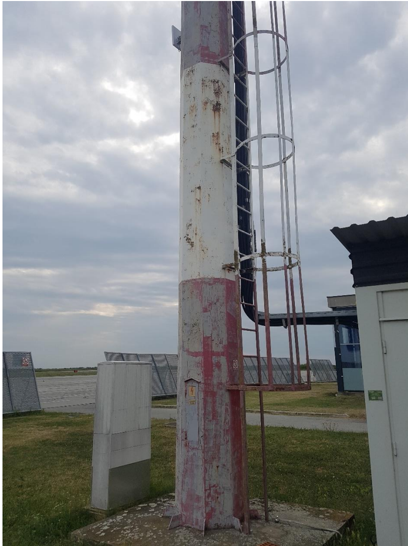
Slika 24. Rasvjetni stup Zračne luke Osijek
