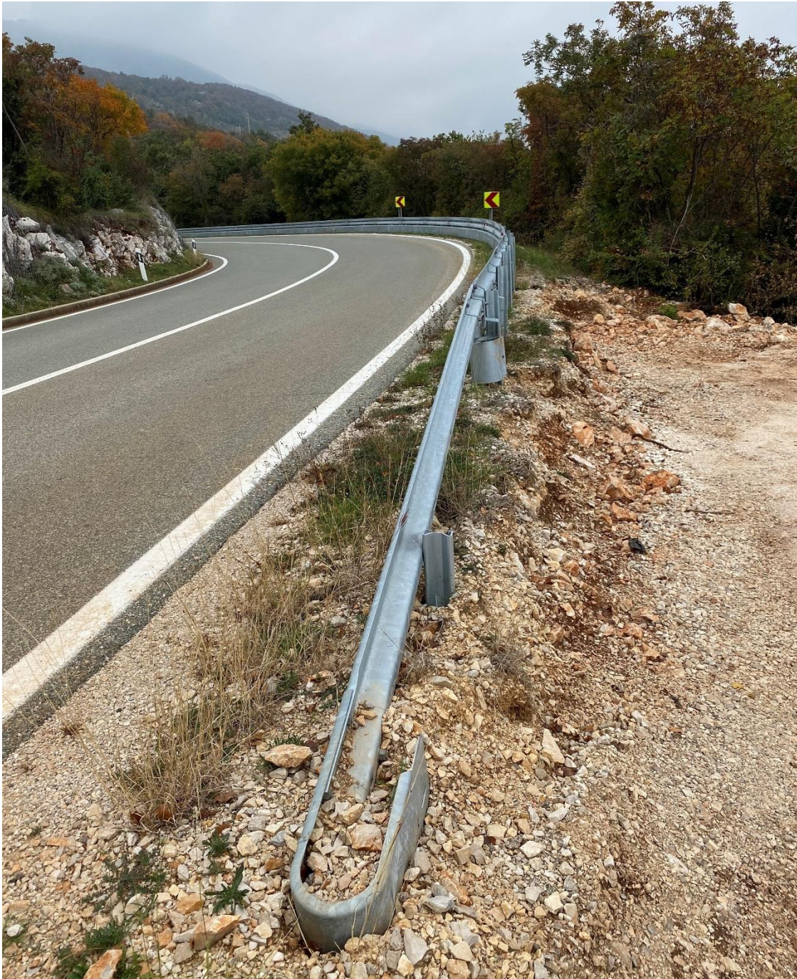
Slika 28. Izmaknuti ukopani terminal na ogradi s dodatnom zaštitom od podlijetanja i pločama K11-1 za označavanje opasnog zavoja na cesti (DC66)
