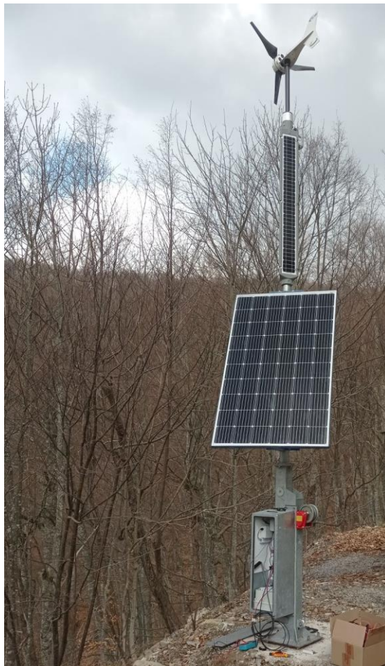
Slika 34. Bazna stanica s baterijom na napajanje solarnom i energijom vjetra Izvor: [68]
