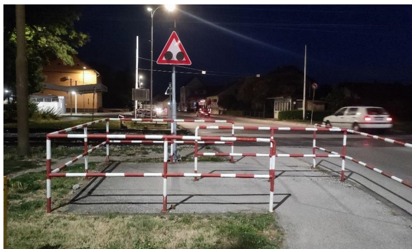
Slika 11. Mimoilazna zaštitna ograda na željezničko-cestovnom prijelazu
