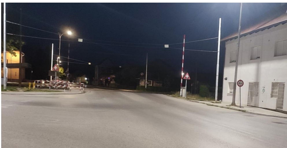
Slika 14. Prometna signalizacija i znakovi na željezničko-cestovnom prijelazu
