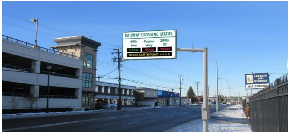
Slika 34. Displej s informacijama o dolasku vlaka na željezničko-cestovni prijelaz. [21]
