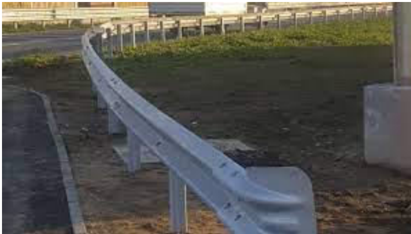
Slika 7: Prikaz zaštitne ograde
