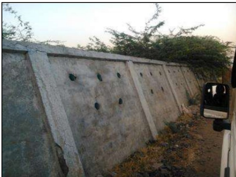
Slika 21. Nagnut i oštećen zid na zračnoj luci Surat, [25]
