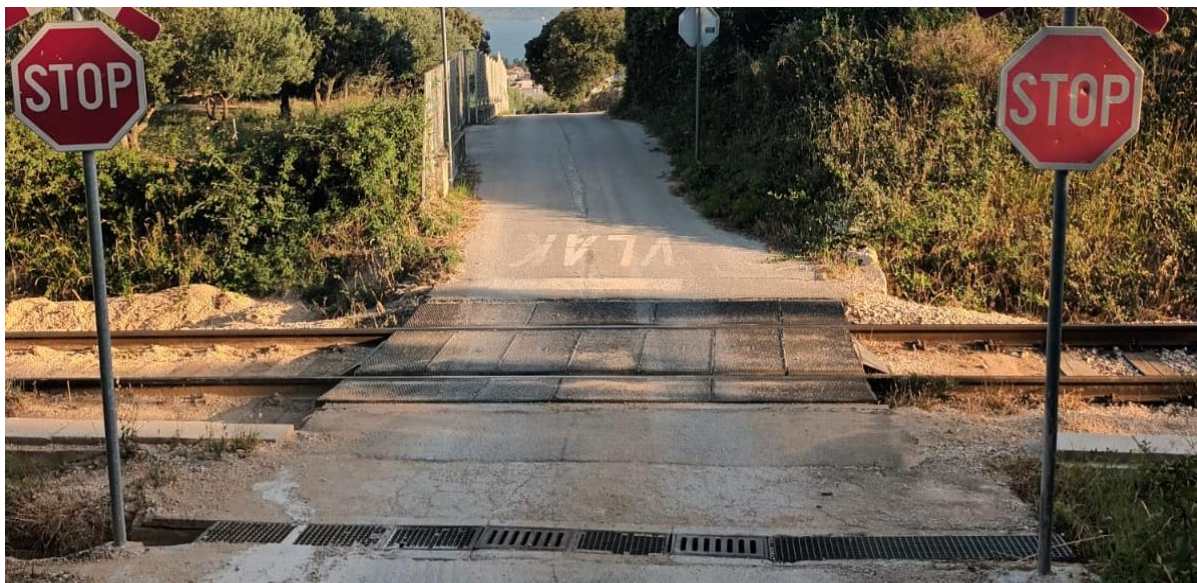
Slika 59. Prikaz stanja gumirane podloge na željezničko-cestovnom prijelazu „Kaštel Stari“
