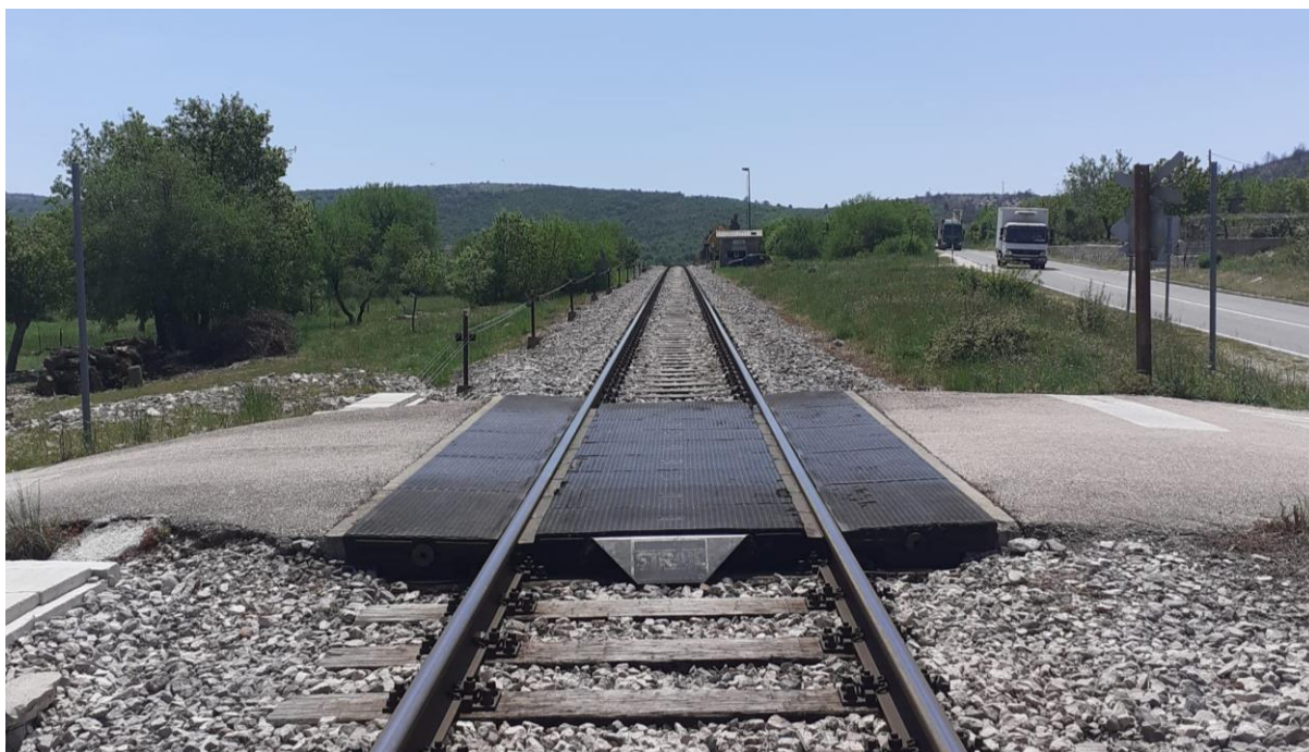
Slika 39. Prikaz stanja gumiranih ploča na željezničko-cestovnom prijelazu „Labin“
