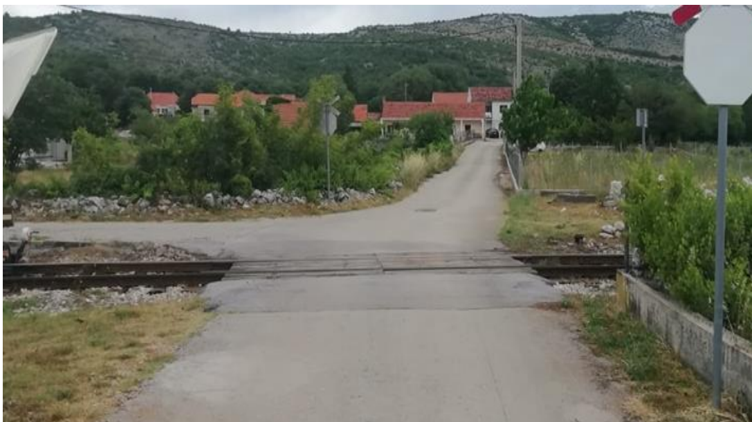
Slika 22. Prikaz stanja podloge od drvenih pragova na željezničko-cestovnom prijelazu „Stojaci“
