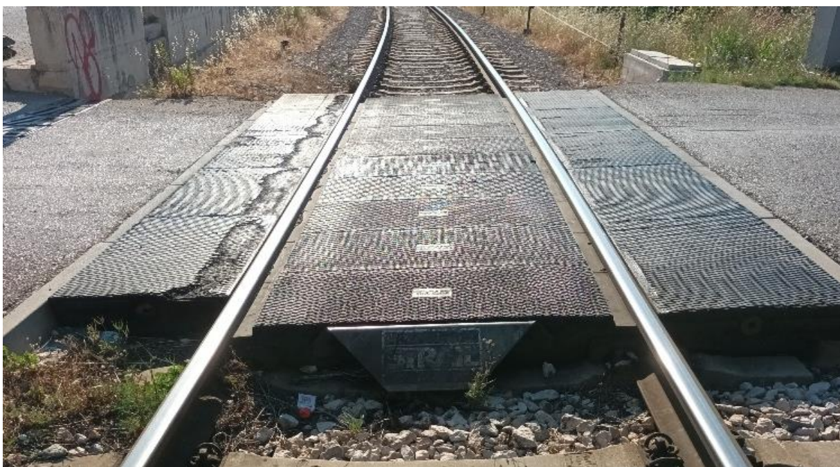
Slika 75. Prikaz stanja gumirane podloge na željezničko-cestovnom prijelazu „Jadranovo igralište“
