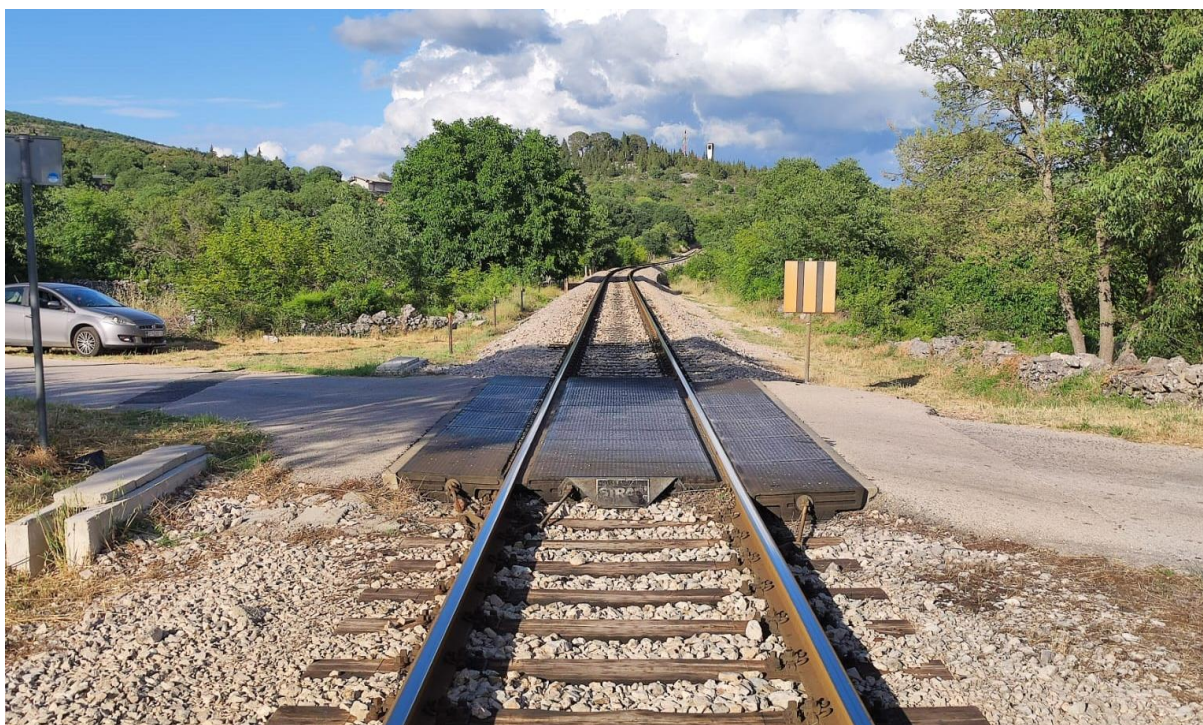
Slika 26. Prikaz stanja gumiranih ploča na željezničko-cestovnom prijelazu „Vržinov“
