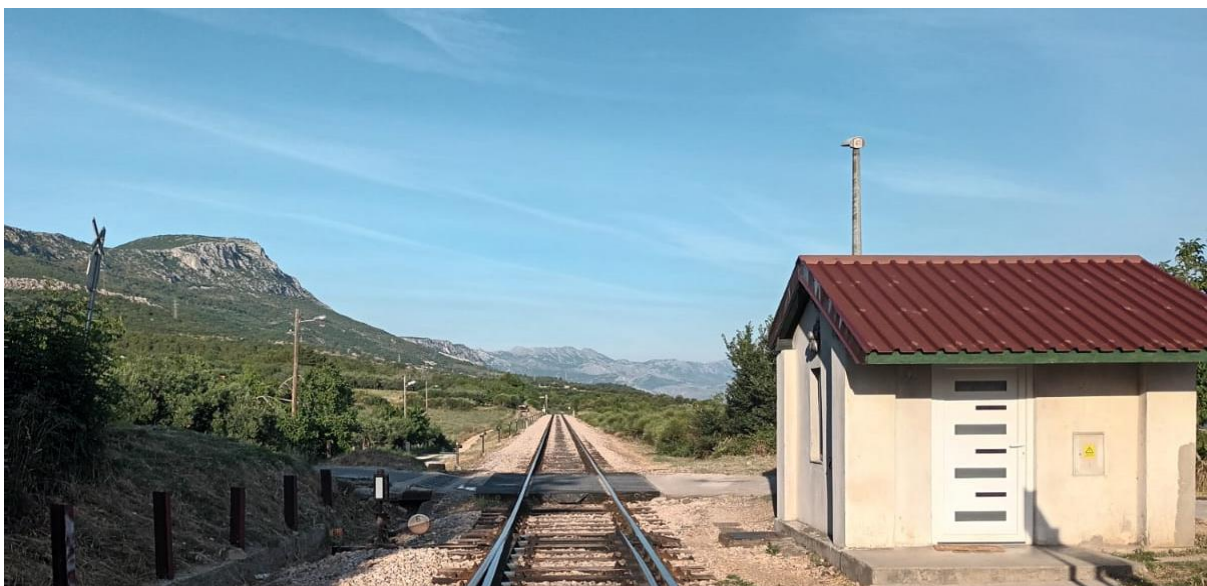
Slika 55. Prikaz stanja gumirane podloge na željezničko-cestovnom prijelazu „Kaštel Stari 2“
