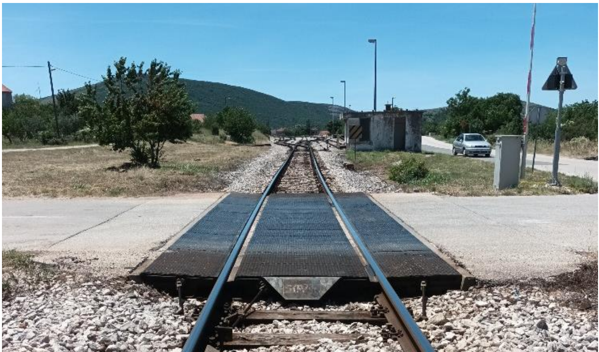
Slika 10. Prikaz stanja gumiranih ploča na željezničko-cestovnom prijelazu „Perkovići“
