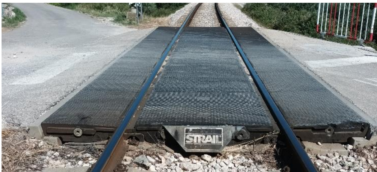
Slika 67. Prikaz stanja gumirane podloge na željezničko-cestovnom prijelazu „Kaštel Lukšić“
