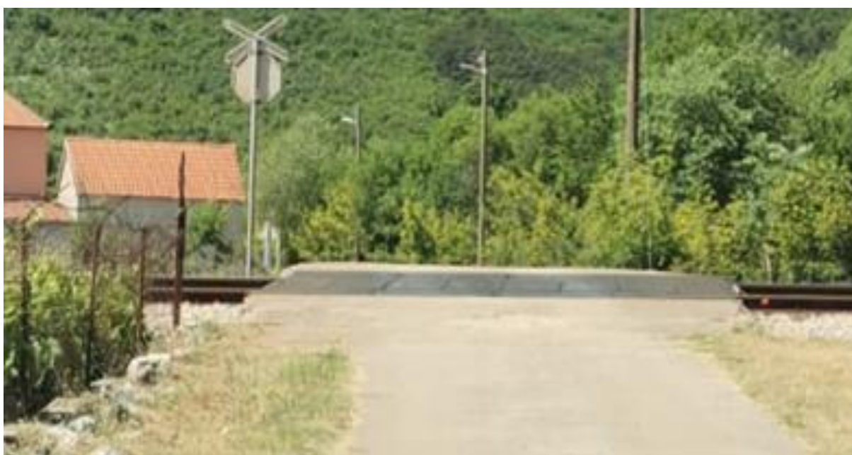
Slika 18. Prikaz stanja gumiranih ploča na željezničko-cestovnom prijelazu „Balovljev“
