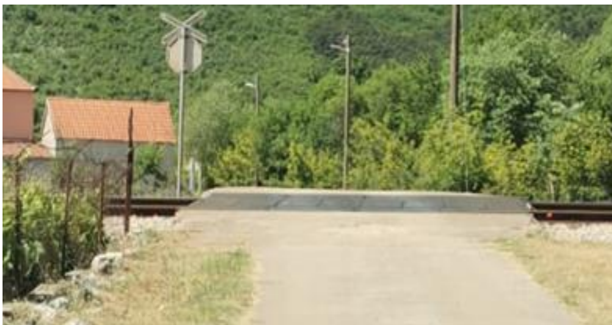
Slika 18. Prikaz stanja gumiranih ploča na željezničko-cestovnom prijelazu „Balovljevi“
