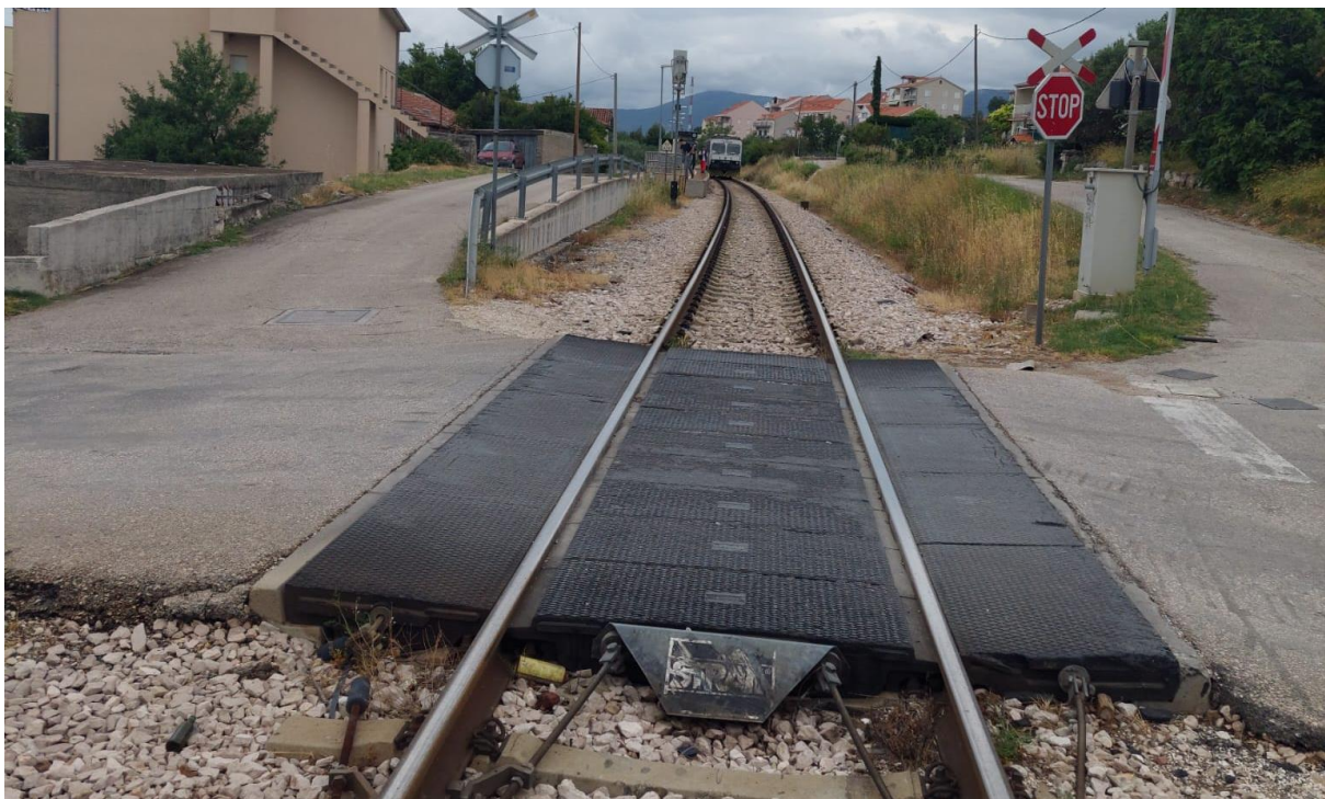
Slika 71. Prikaz stanja gumirane podloge na željezničko-cestovnom prijelazu „Kaštel Gomilica“
