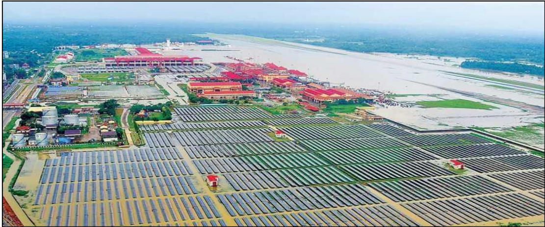
Slika 8. Sustav solarnih panela na zračnoj luci Cochin, [35]
