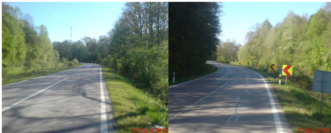
Slika 15. OM Šuma Brezovica – prije sanacije
