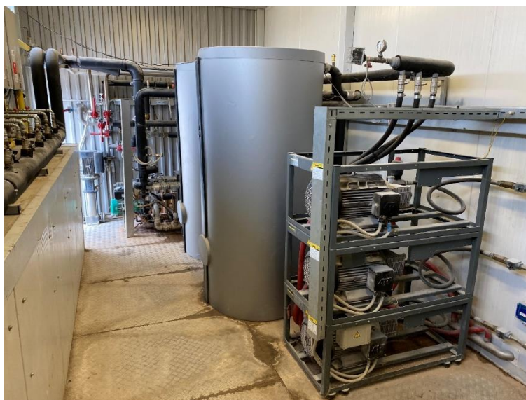
Slika 20. Strojarnica sustava za pranje
