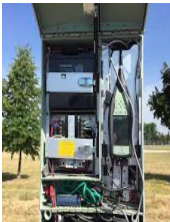
Slika 6. Unutarnji izgled vodootporne kutije za procesiranje podataka o buci sa svim njezinim dijelovima, [12]
